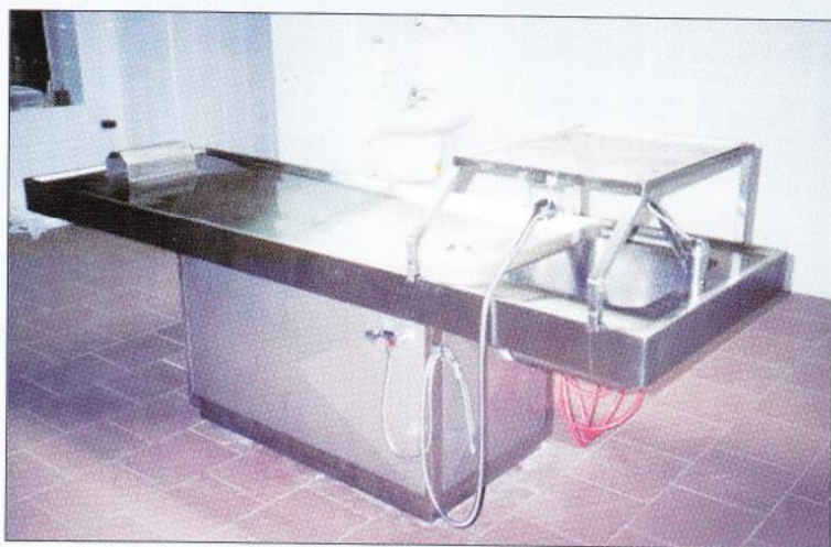
Spółdzielnia Pracy "Universum" w Poznaniu. Stół sekcyjny zainstalowany w 2001 r. w Zakładzie Kremacji na cmentarzu Miłostowo.
